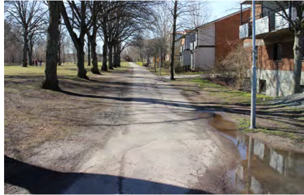
Figur 14. Gång- och cykelväg vid Tavastehusgatan i Ekeby. Stående vatten, sprickor i beläggningen och tjälskador.
