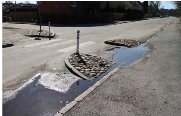
Figur 15. Passage över Karlsrogatan i höjd med Hagundagatan. Den bristfälliga avvattningen leder till ett lågt utnyttjande av passagen.
